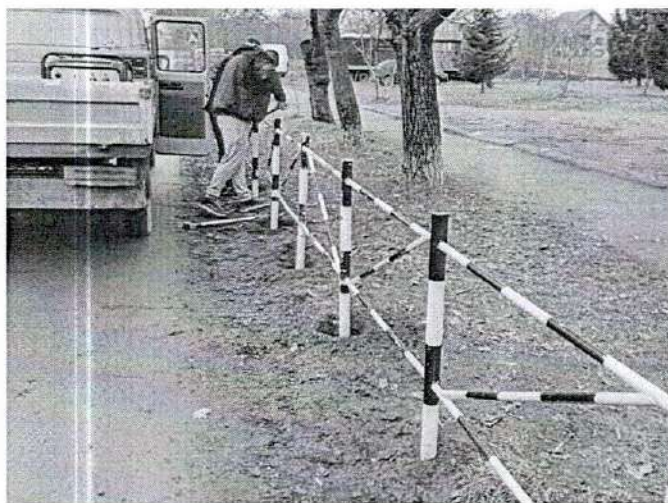
Санирано оштећење на заштитној пешачкој огради поред спортског терена у улици Бановић Страхиње у Инђији
